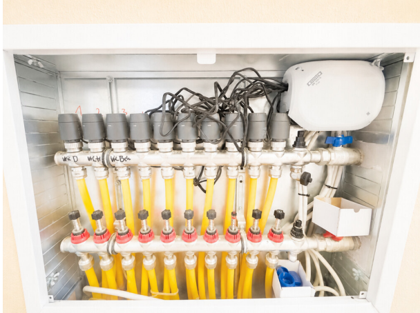
Gewerbefläche EG - Fußbodenheizung
